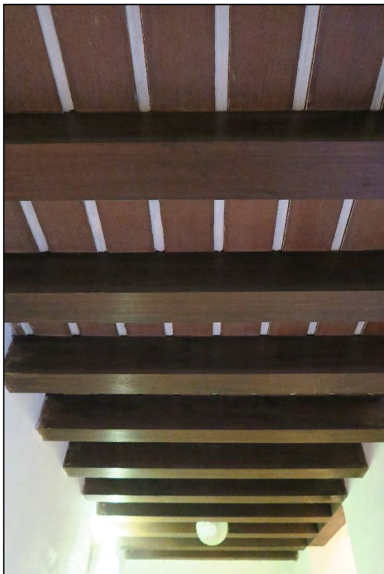
80 Plafond in één van de verkeersruimtes.
